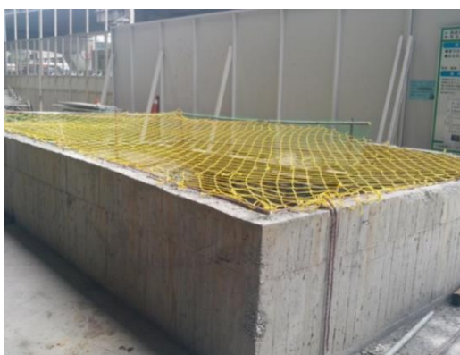
樓梯防護標準設施
